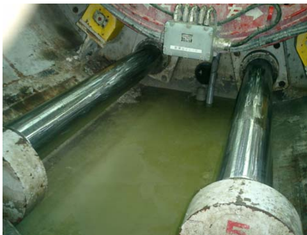
シールドジャッキ
